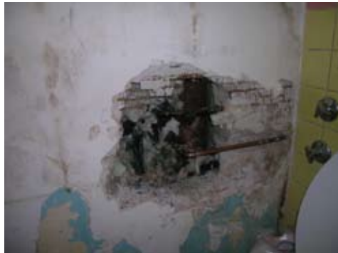
Schimmelbefall und Schäden im Versorgungsschacht
