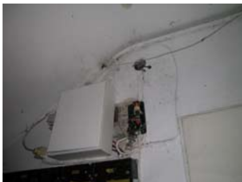
Fehlende Abdeckung der Elektroverteilung
